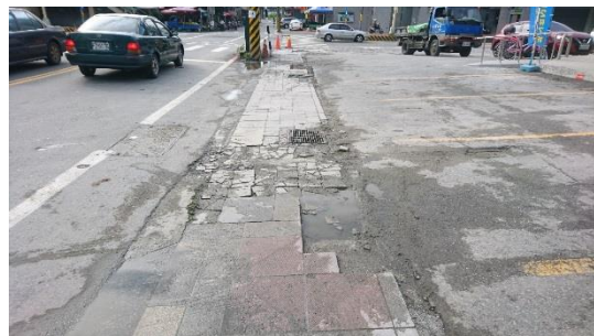
圖2 人行道高壓地磚破壞
